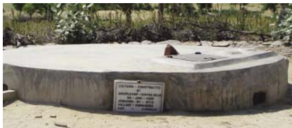
Cisterna para armazenar a água da chuva.
