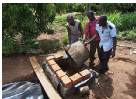
Déversement de fumier dans un digesteur à biogaz.
