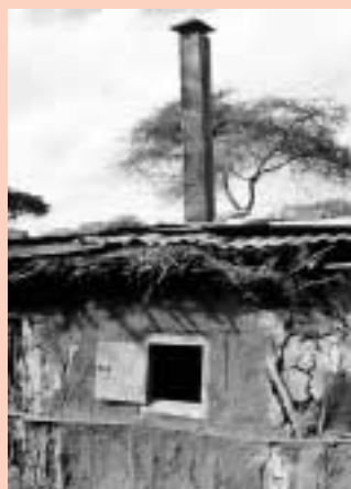
Casa massai tradicional, mas com chaminé e janela para diminuir o fumo na casa.
