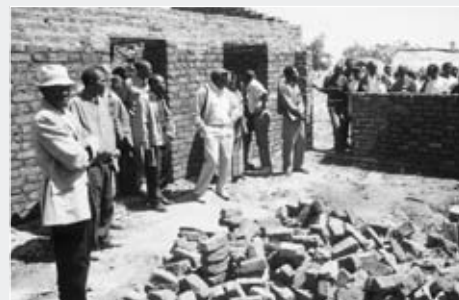
Membres de la communauté avec les maisons d'enseignant qui sont construites sans ressources extérieures à la communauté.
